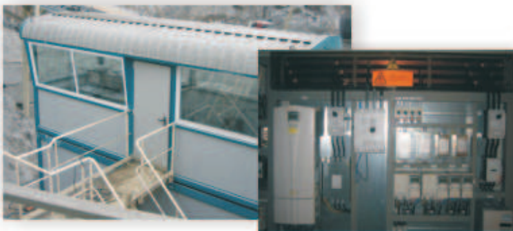
ОПЕРАТОРСКИЕ С СИСТЕМОЙ УПРАВЛЕНИЯ CABINET OF CONTROL AND FORCE
